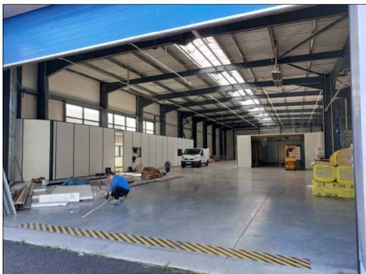
Vue générale de l'entrepôt, avec les chambres froides à droite, les bureaux à gauche. La ch. froide négative sera située devant, à droite
