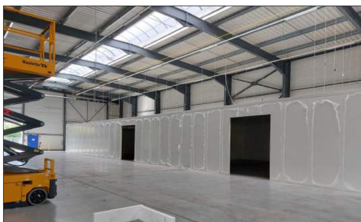
Les deux chambres froides positives d'un surface totale de 300m2
